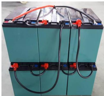
72V akkumulátorok kötése
